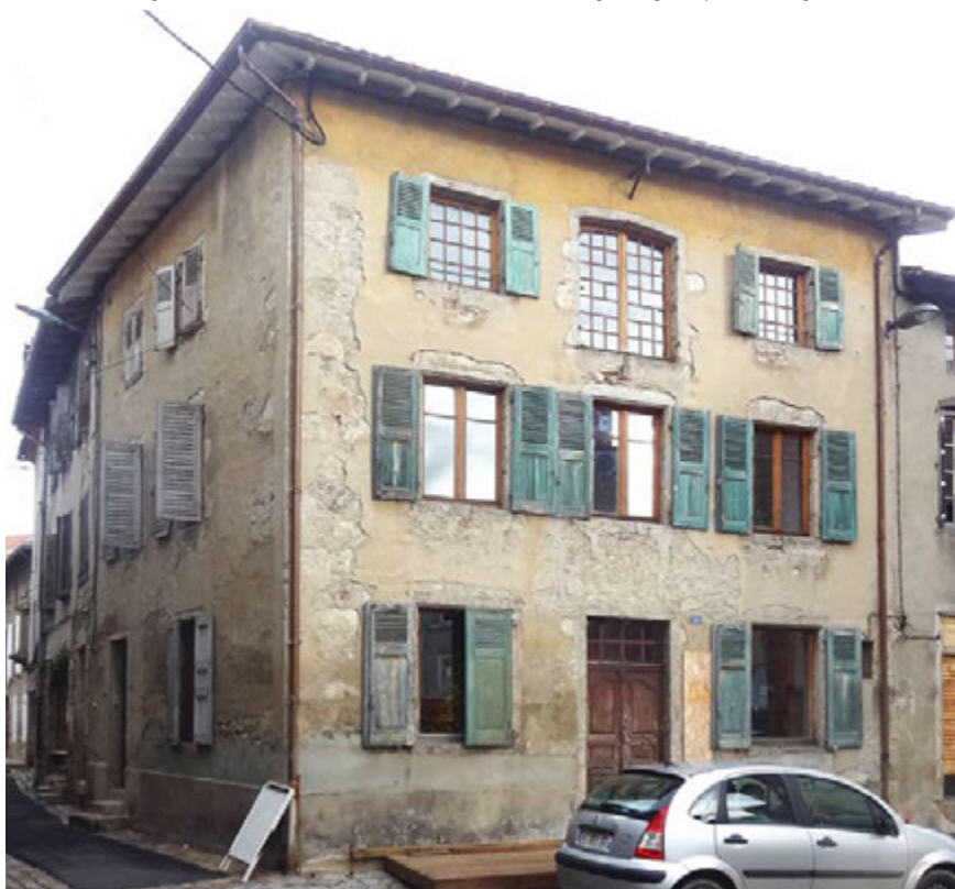
Maçonnerie pierre + décollement du enduit à la chaux trop âgé + soubassement enduit ciment
